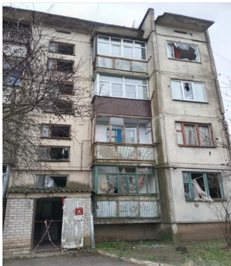
Многоквартирный дом Александра серьезно пострадал. У входа в дом виден знак «Опасно, мины», установленный украинскими саперами после инцидента.
